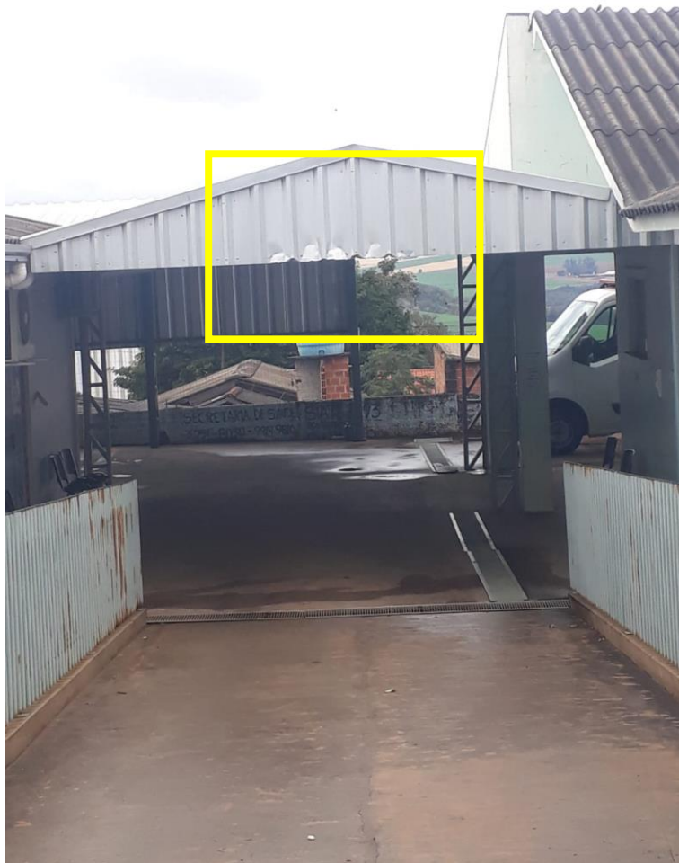
Unidade Básica de Saúde de Ouro Verde do Oeste, 2021. Em destaque: estrutura que dá acesso aos veículos municipais da Secretaria de Saúde à garagem, mas dificultam o acesso de veículos de porte maior, como as ambulâncias do SAMU.
